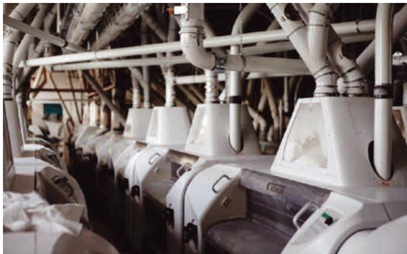
Impianto di macinazione
